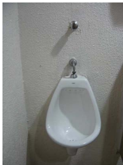
Equipamentos hidráulicos com reguladores de vazão.
