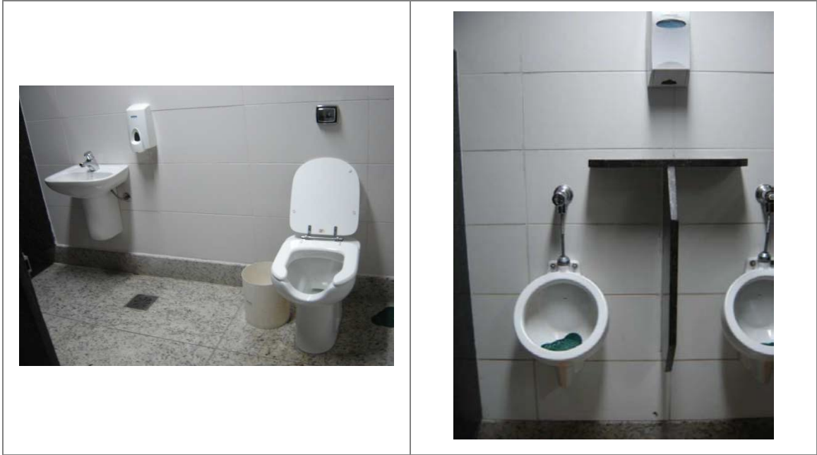
Equipamentos hidráulicos com reguladores de vazão.
