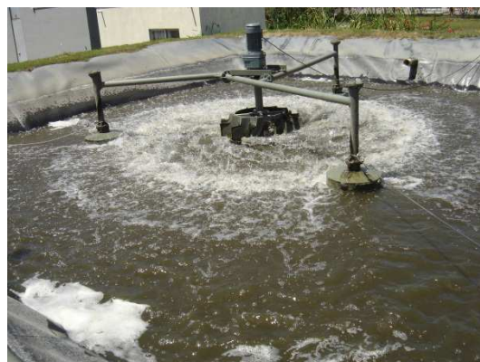
Estação de Tratamento de Esgoto
