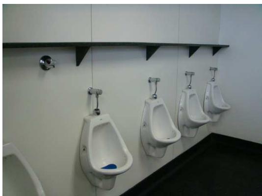
Mictórios com válvulas de fechamento automático
