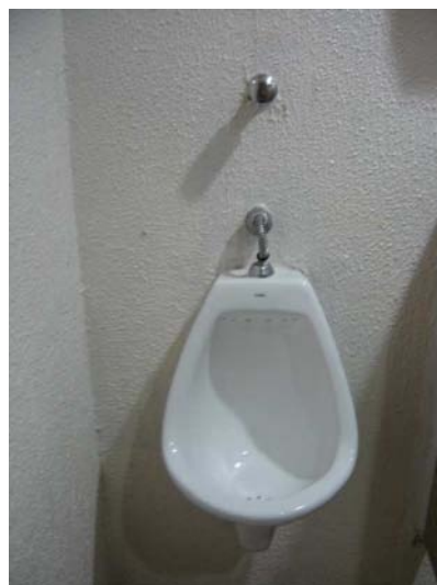
Equipamentos hidráulicos com reguladores de vazão.
